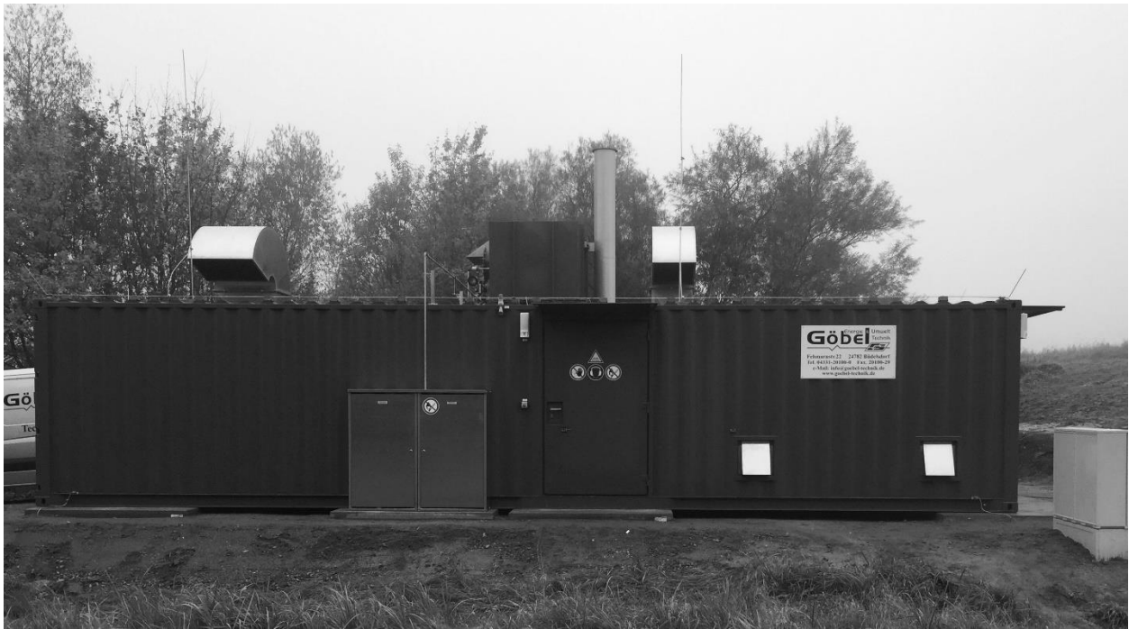
Abbildung 10: Gasverdichterstation mit RTO für ein Deponiebelüftungsprojekt
